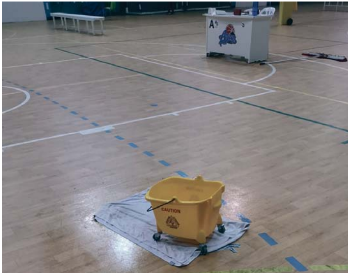
Ha sido preciso recurrir a los cubos para recoger el agua pluvial en el interior del pabellón. CEDIDA POR IU
