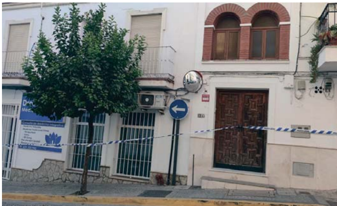
La bóveda dejada por el desprendimiento y el precinto de las viviendas afectadas. MACÍAS
